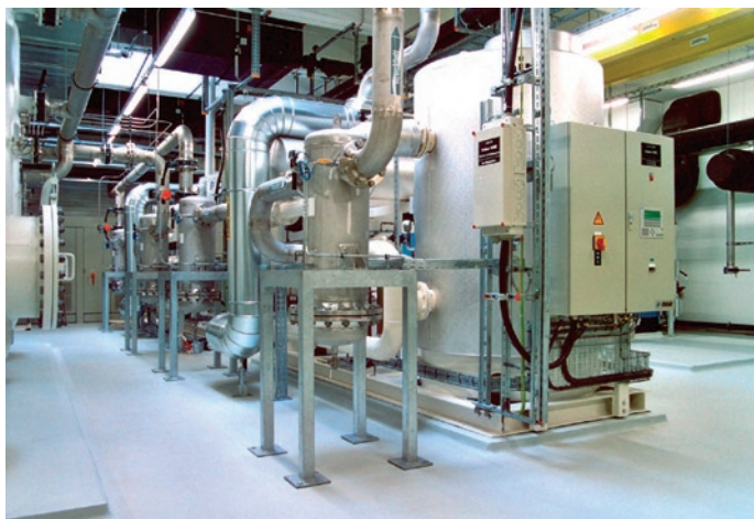
Zwei extern warmregenerierende Adsorptionstrockner mit Vor- und Nachfilter, Differenzdruckanzeige, Schwellwertüberwachung und Umgebungsleitung
