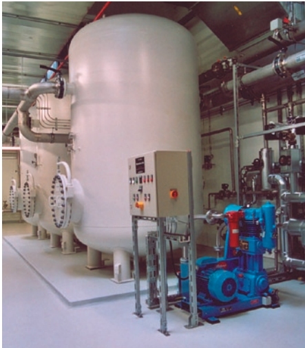
Vor den drei 10-m 3 -Druckluftbehältern sieht man den ölfreien Nachverdichter für 16 bar Höchstdruck
